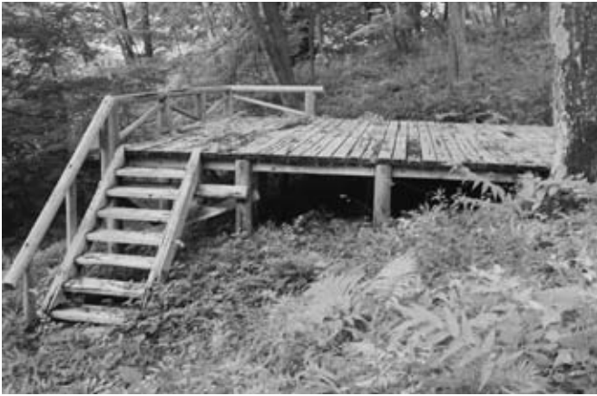
腐食が進むテントデッキ
