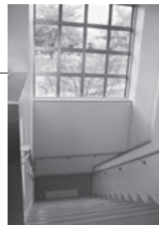
◀階段は、滑り止めや手すりを備えています
