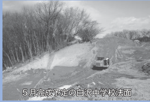
白沢中学校法面崩落
