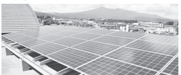
▲市役所に設置された太陽光発電パネル
