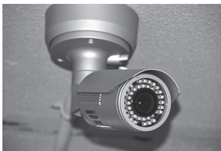
市内計 32 カ所に設置される防犯カメラ
