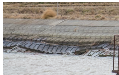
波よけブロックが崩落した大谷池
