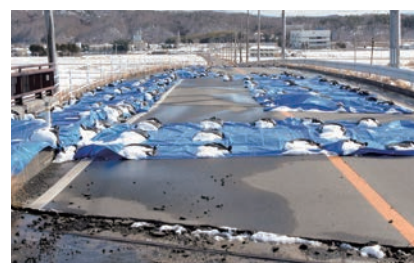
舗装クラックや、路面沈下のため現在も通行止めとなっている富士内・上沢線
