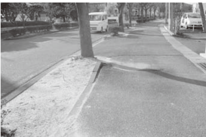
街路樹の成長で盛り上がった舗装
