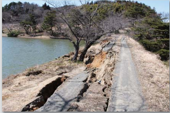
蛇ノ鼻中ノ池堤体崩壊
