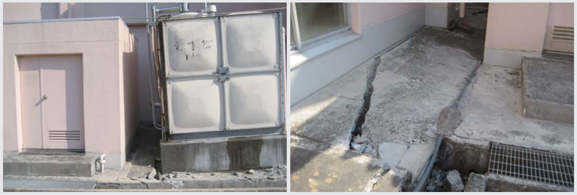
(写真左) 貯水槽の基礎が崩れ、傾くタンク。(写真右) 犬走りのコンクリートも割れた
