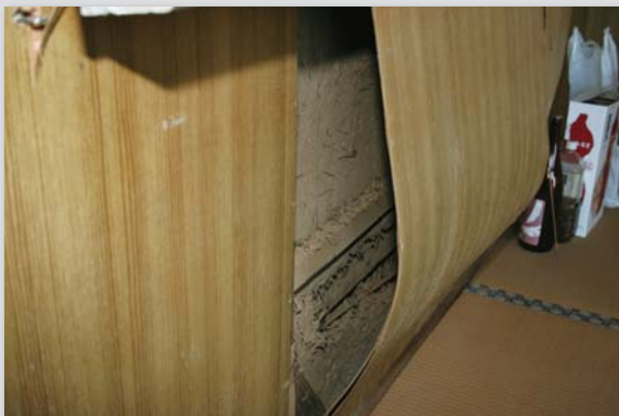
内壁の合板をはがれたほか、天井の一部もはがれた
