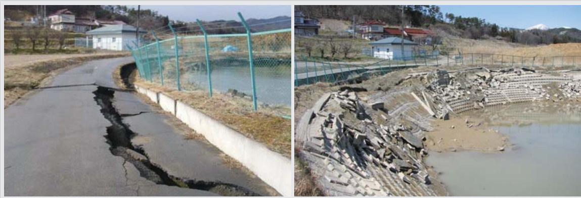
西ノ池貯水池の側道（写真左）に亀裂が入り、池の護岸ブロックが崩落（写真右）
