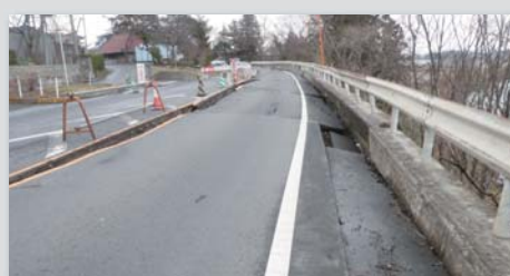
写真左右とも岩根字本郷地内、県道本宮・熱海線。センターラインから南側五百川沿いの土手が崩落し、道路が陥没
