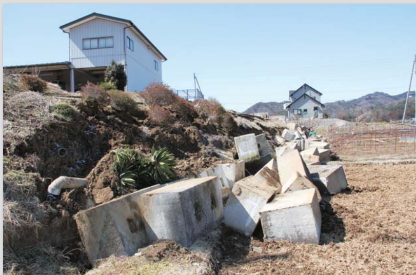
青田字寄松地内、積み石崩落
