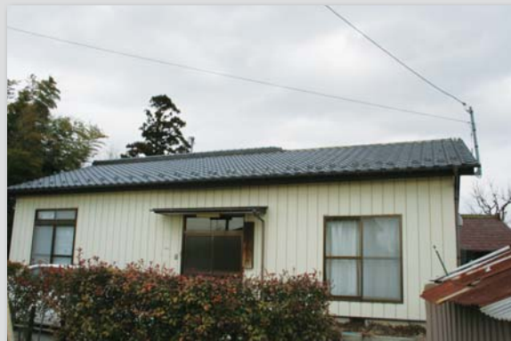
ぐし瓦が崩落。建物内も壁紙に無数の亀裂が発生
