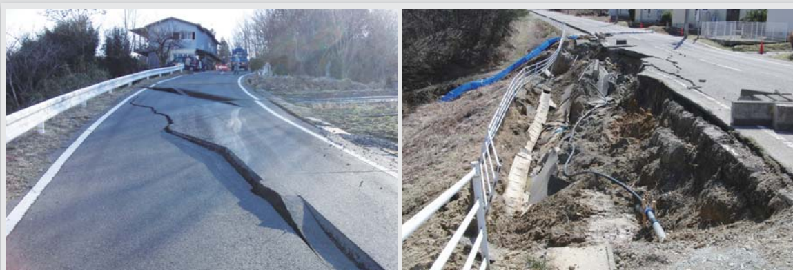
和田字下見沢地内市道岫・下見沢線（写真左）と、糠沢字石神地内、市道石神・堤崎線（写真右）
