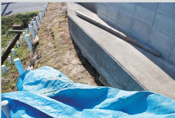
敷地北側法面が崩落。建物内でのモルタルの土間に亀裂が入った
