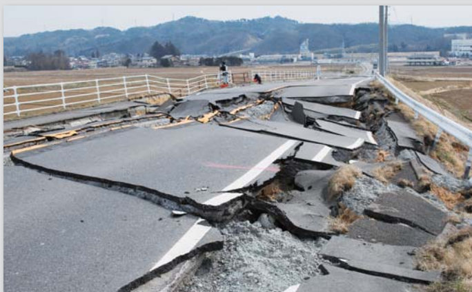
市道富士内・上沢線。アスファルトは飽細工を壊したようにバラバラに
