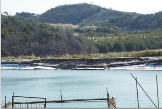
岩根の大池、堤体崩壊
