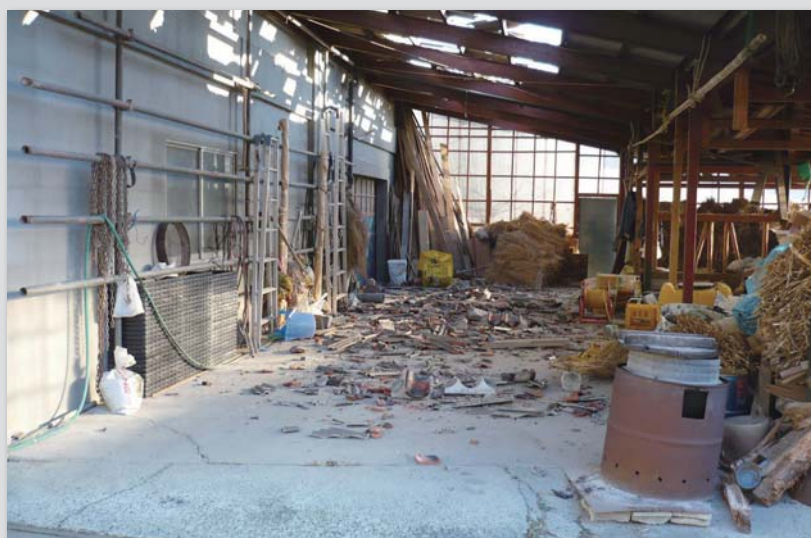
一般住宅、瓦が作業小屋の屋根を突き破る
