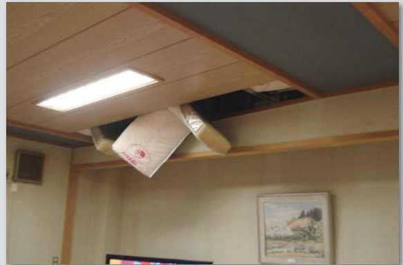
糠沢分館天井板破損
