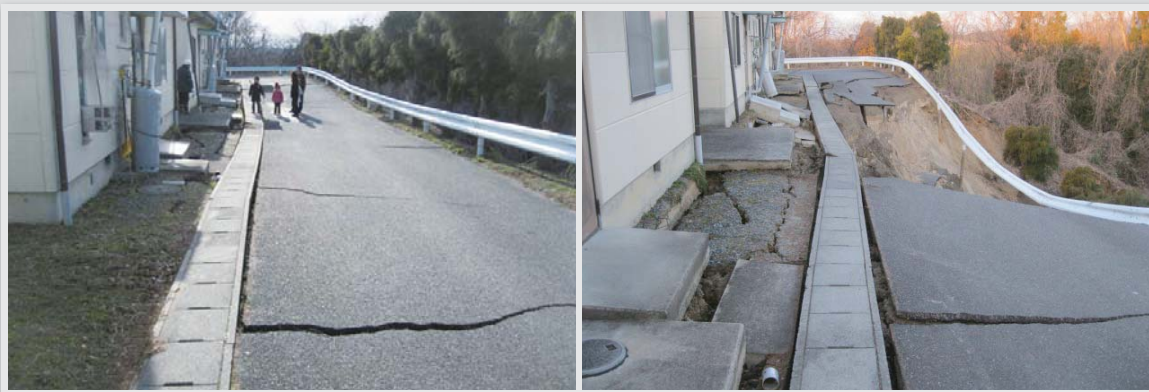
糠沢字石神地内、震災直後の石神市営住宅（写真左）と、一夜明けて道路が陥没（写真右）
