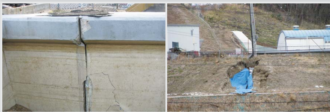
立石山浄水場緩速ろ過池壁面に亀裂が入り、水があふれ出た（写真左）。あふれ出た水で南側法面が崩落（写真右）
