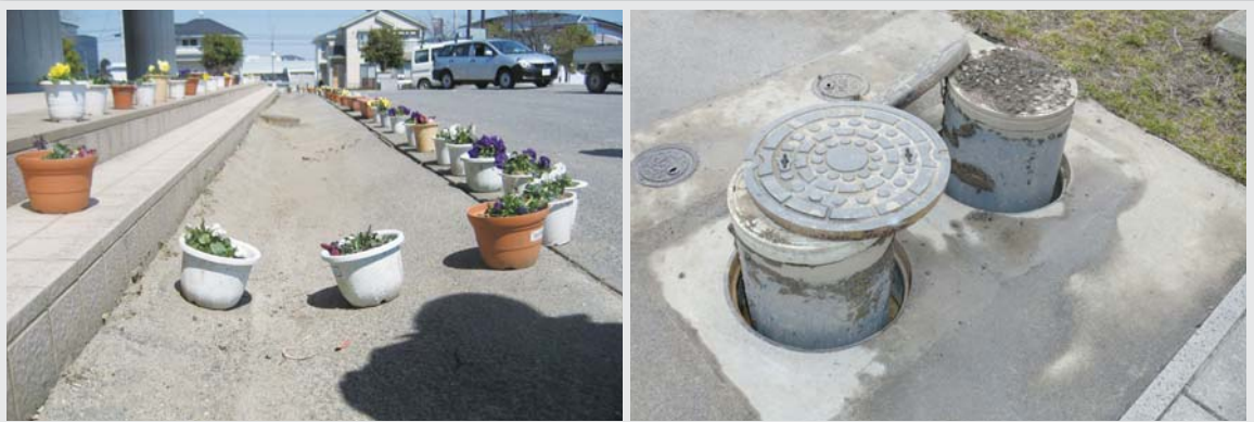
昇降口の下舗装が沈下（写真左）。保健室前のマンホールのふたが持ち上がった
