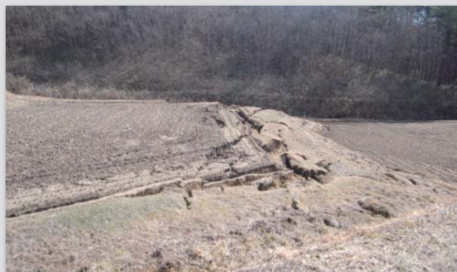
稲沢字堂平の水田法面が崩落
