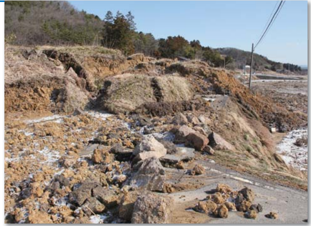
青田新池の堤体崩落
