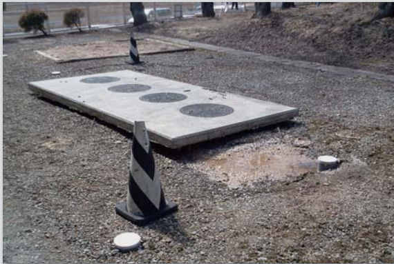
長屋分館、合併処理浄化槽隆起損壊
