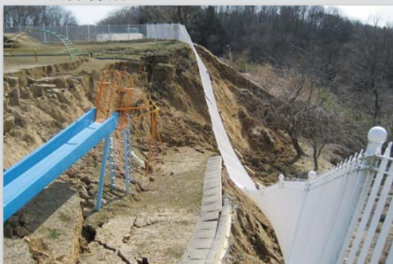
園庭は西側の法面が崩落。フェンスや滑り台も崩れ落ちた
