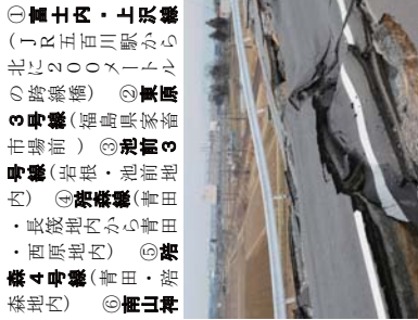
▲富士内・上沢線の被害状況(4月7日撮影)
