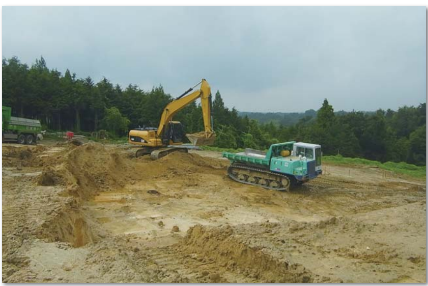
造成工事を進めている長屋地区仮置き場（平成25年8月5日撮影）
