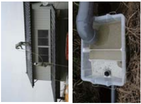
(上) 屋根瓦を高圧洗浄をする様 子 (下) 除染作業に使用した水 はばけろ 二重にろ過する方法がとら れました
