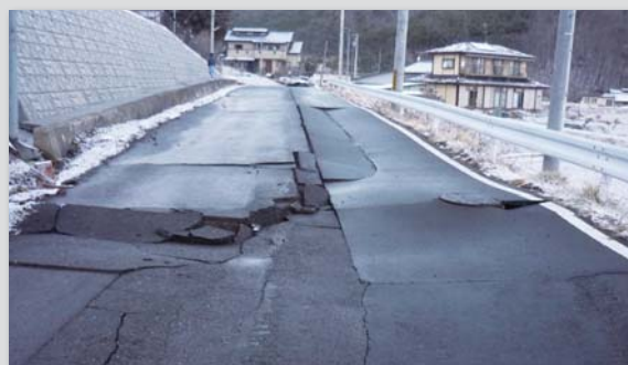
青田字碓森地内、市道碓森線。道路に亀裂が走る
