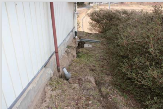
敷地東側の法面が崩落。建物も東側に傾く
