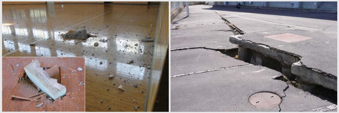
白沢体育館アリーナ、コンクリート片落下、駐車場地盤沈下
