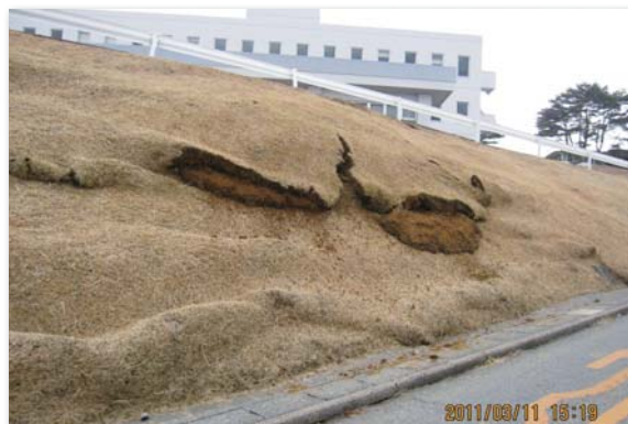
地震により敷地内も被害を受けた
