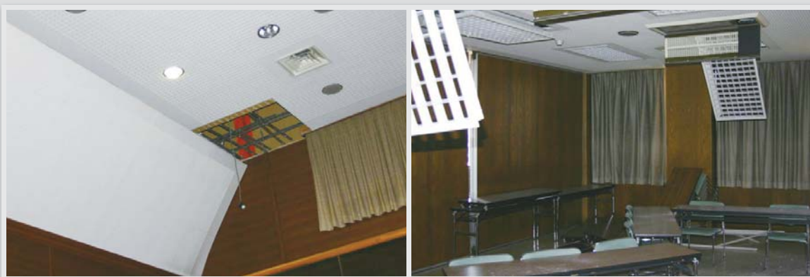
市役所3階、議場の天井板の落下（写真左）と、大会議室の天井が破損（写真右）
