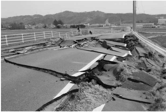
▲富士内・上沢線の被害状況
