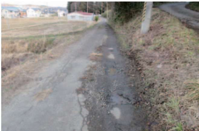
▲古い市道の早急な修繕を
